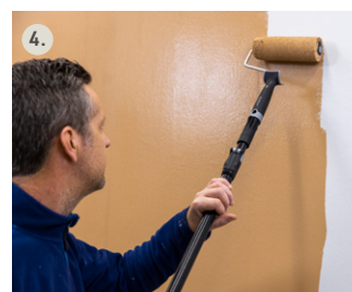
4. Slettveggen er forgrunnet og trenger bare 2 strøk maling!
