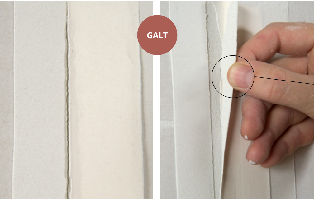
Sparkelremsen løsner fra ytterkanten; kantslipp.
