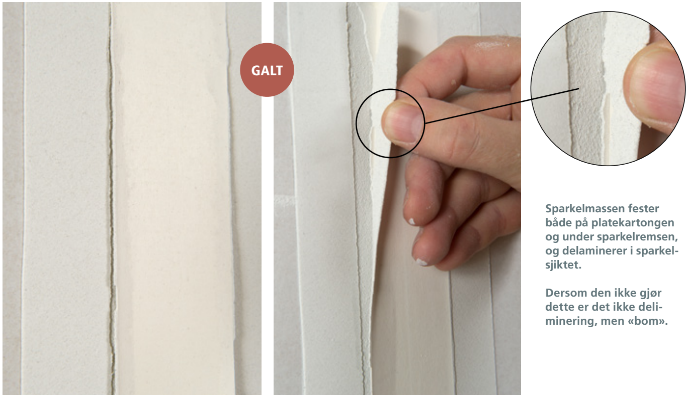
Sparkelremsen løsner fra ytterkanten; kantslipp.
